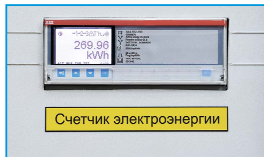
Power meter ABB
