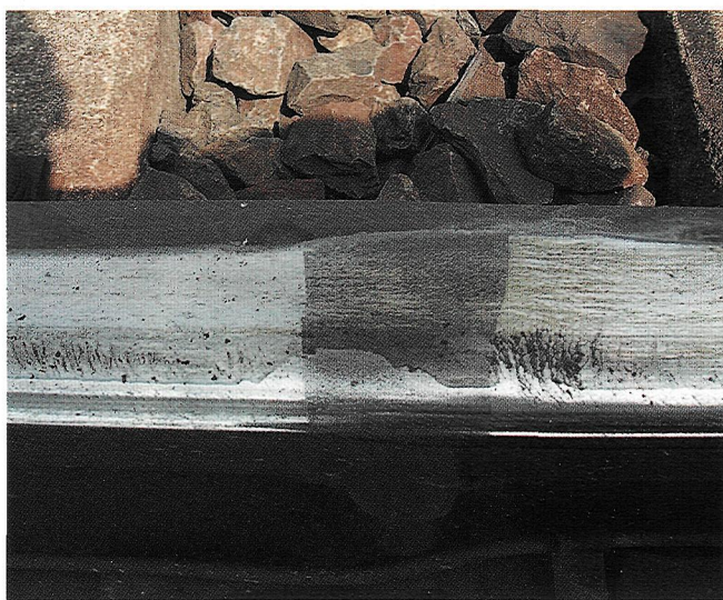
Рис. 16. Микротрещины по обе стороны сварного стыка (в самом сварном стыке нет трещины)
