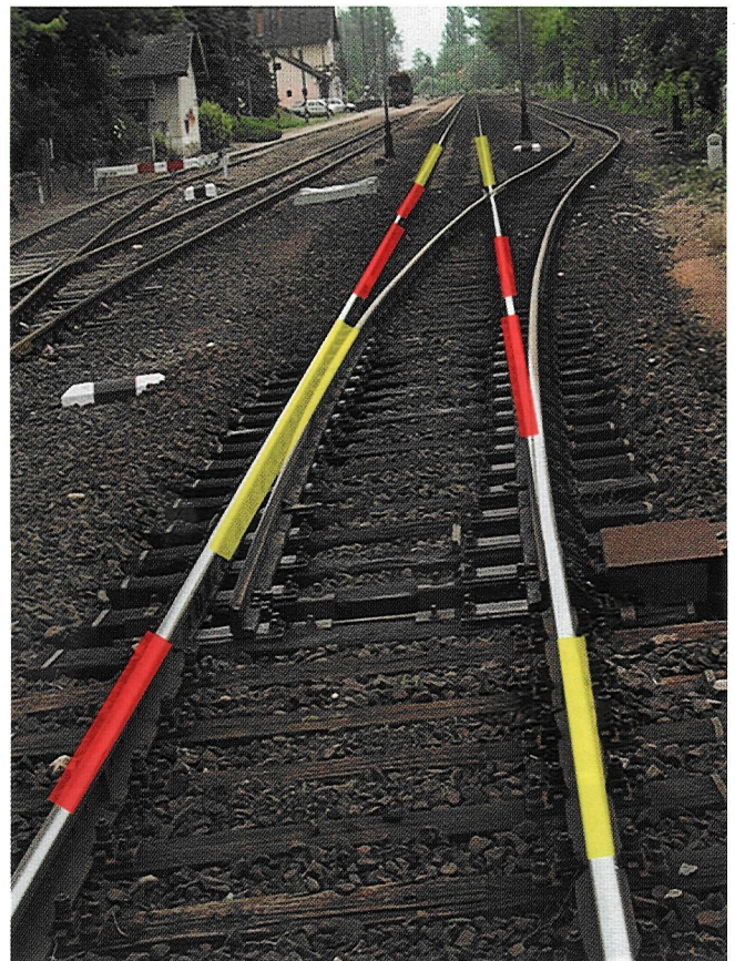
Рис. 13. Характерные места появления дефектов head checking в простых стрелочных переводах
