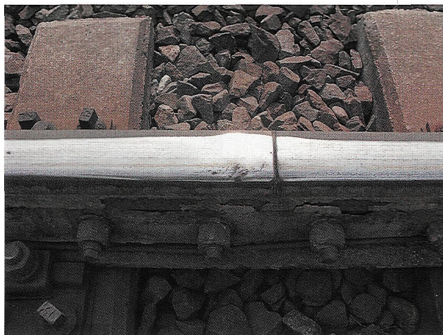
Рис. 18. Микротрещина в клееболтовом изолирующем стыке
