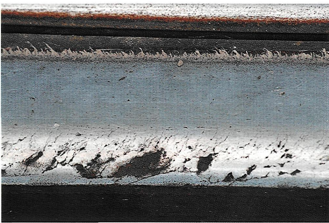
Рис. 8. Под темными пятнами трещины head checking уже срослись
